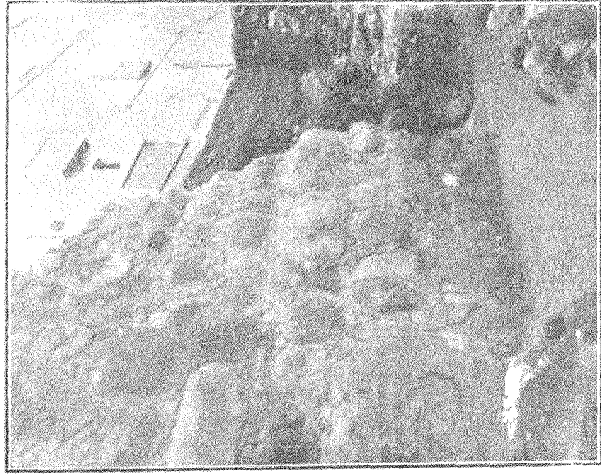
Lámina 1. - Hundimiento en el muro de Carretas. A la izquierda, restos del muro romano desfigurados por los rayos.
